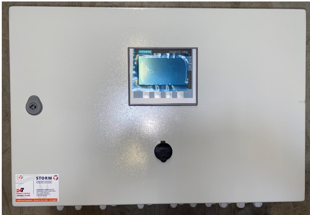
Abbildung 1 – NO x -Logger Schaltschrank (Normalansicht)
